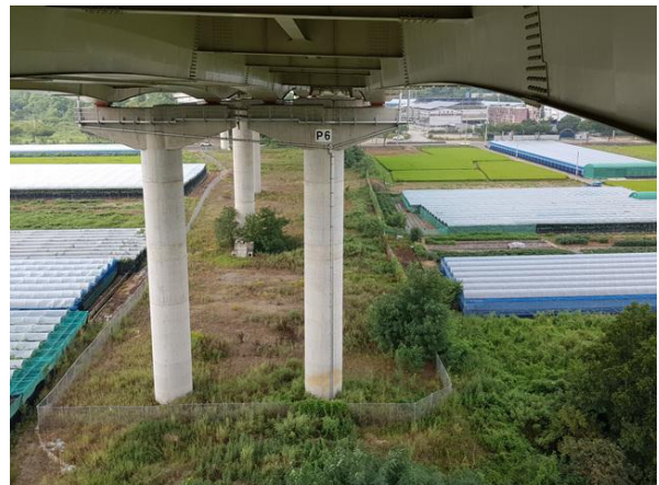
교각 P6 상태현황
