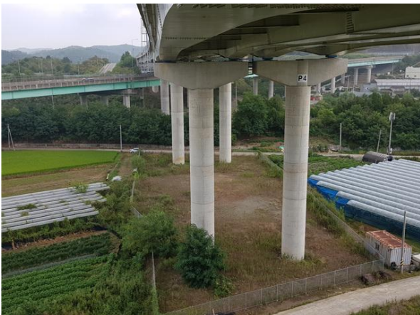
교각 P4 상태현황
