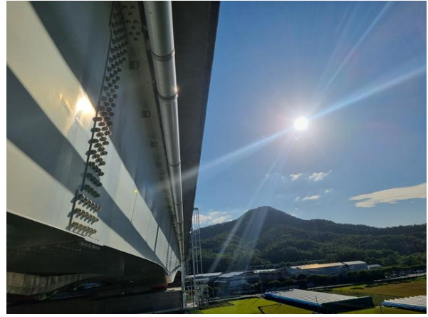
바닥관하면 S6 외측 캔틸레버 상태현황
