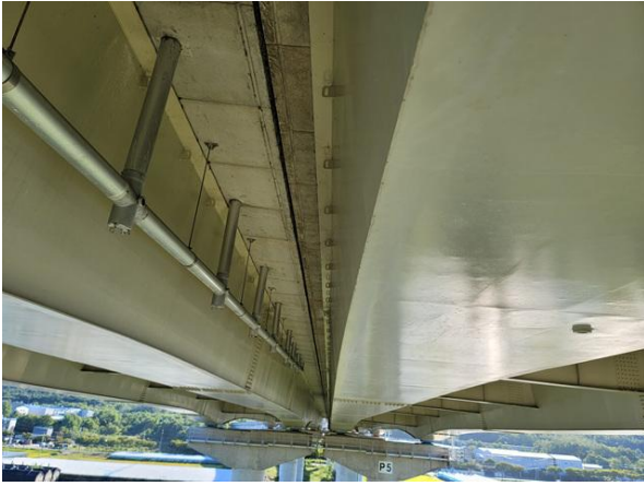
바닥관하면 S1 내측 캔틸레버 상태현황
